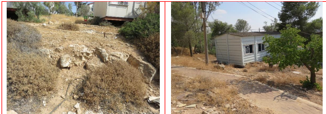
אזור תכנון 2 - מימין, מבט לדרום מזרח מנ.צ. 217440/593440, במגרשים המיועדים לבינוי וסביבתם פזורים מבנים ומתקנים, לצידם מערכת שבילים ודרכים פנימיות כמו גם ריבוי בתשתיות על ותת קרקעיות. משמאל, מקומית תחת מילוי המתנשא לגובה עשרות ס"מ עד כמטר וחצי, נחשפים סלעי השתית הטבעית שעיקרם גיר דולומיטי קשה.
